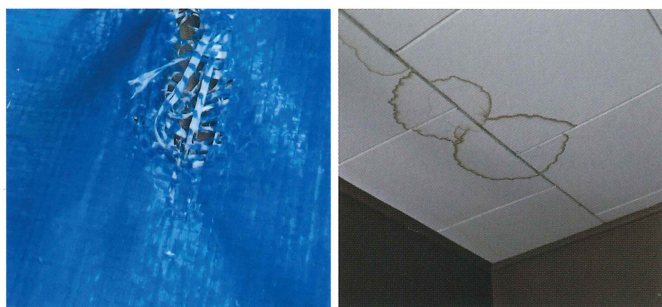
ブルーシートの穴は漏水の原因に・・・
